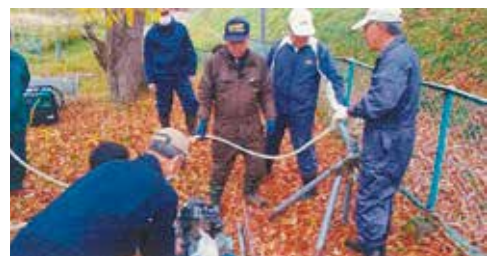
自家発電機で地下水汲み上げ
