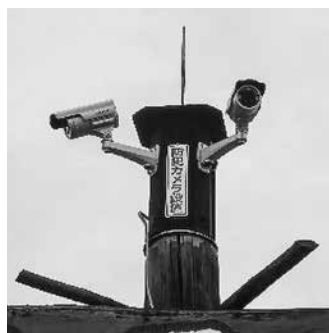
設置した防犯カメラ
